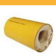
TUBERÍA CON SARRO INCRUSTADO
